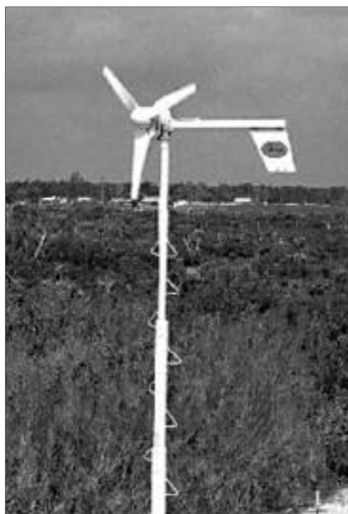
El Aerogenerador Avispa-IIE
